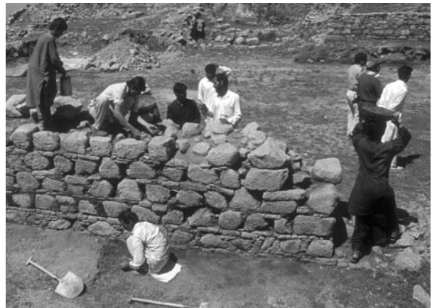
パキスタン・ガンダーラ地域のラニガト遺跡における、伝統的土壁工法を応用した新しい保存処置施工
