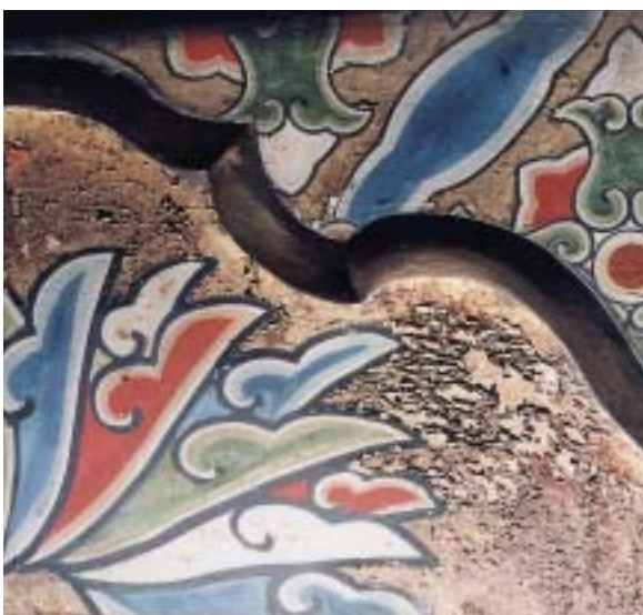
写真2 剥落止め処置前
